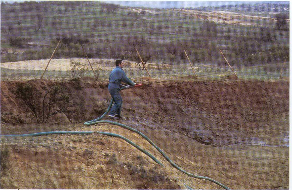
● Primera fase de la hidrosiembra: aplicación de compuestos orgánicos y minerales, mulch, semillas y agua.
