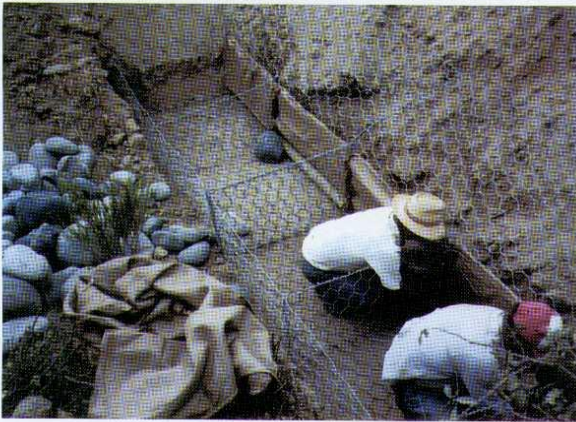
● Etapa de construcción de un dique de estructura gavionada con malla hexagonal de alambre, bolones de río y cubrimiento con sacos de yute en cara anterior.
