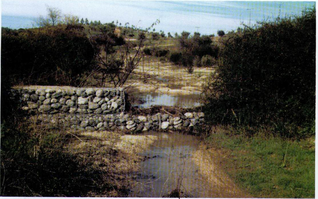
● Vista general de un dique de estructura gavionada para regular flujos hídricos en el cauce de la microcuenca.
