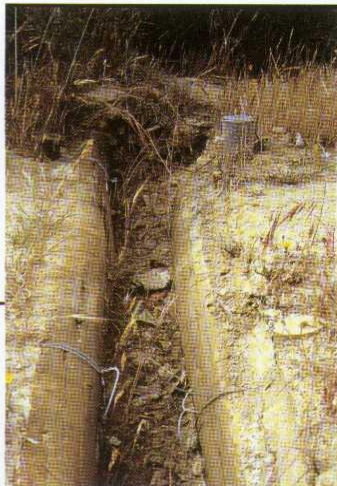
● Primer plano de un canal transversal compuesto con postes de pino impregnado.
