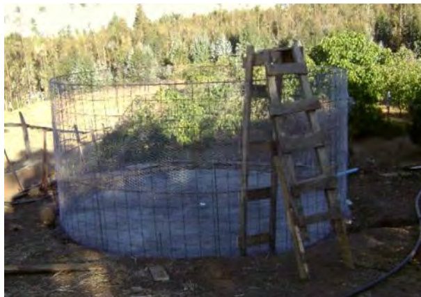
Figura 22. Estructura de la cisterna terminada, para el revestimiento con la mezcla de cemento, arena, y agua.
