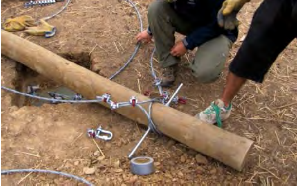
Figura 13. Labor de amarra a la varilla de anclaje del alambre acerado, en la parte superior de cada poste de la estructura.
