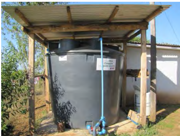
Figura 16. Sistemas de captación y acumulación de aguas lluvias utilizando techos de las casas y estanques acumuladores de 5.000 a 5.400 litros. Comuna de La Estrella, Región de O'Higgins.
