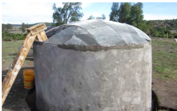
Figura 30. Cubierta de la cisterna, con fierro y malla en condiciones para ser revestida con la mezcla de cemento, arena, y agua.
