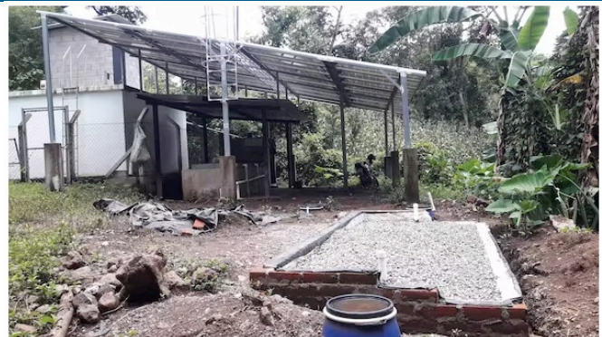
Balsa rellena con grava para depurar las aguas. Author provided
