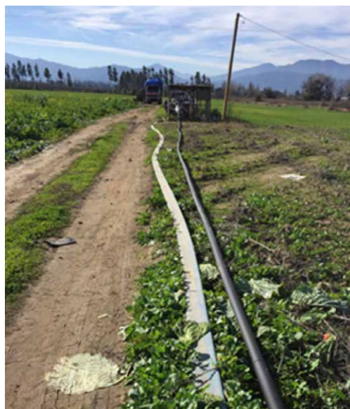
Tubería recubierta para conducción de agua temperada desde pozo. Fuente: proyecto precursor.
