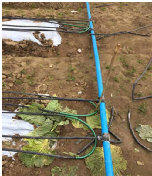
Tuberías de conducción de agua temperada en cada hilera. Fuente: proyecto precursor.
