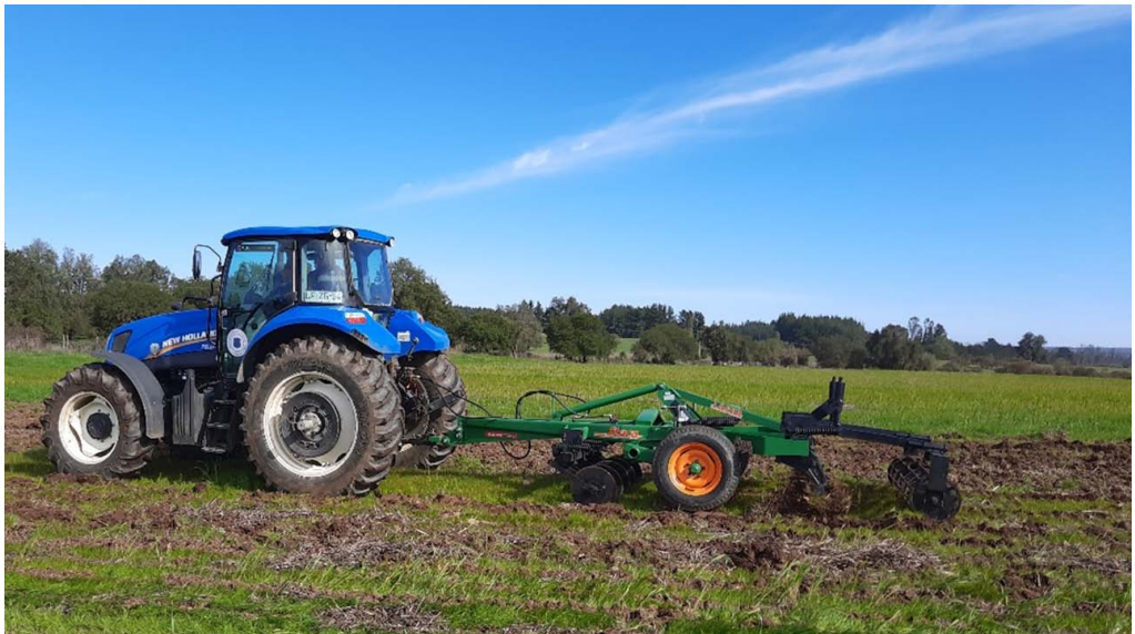
Foto 2.5. Trabajo de escarificado con aditamento de preparación de suelo (discos de corte en la parte anterior y rodillo desmenuzador en la parte posterior).
