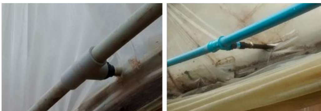
Detalle de conexión de tubería externa de PVC con tubería interna (proyecto precursor).
