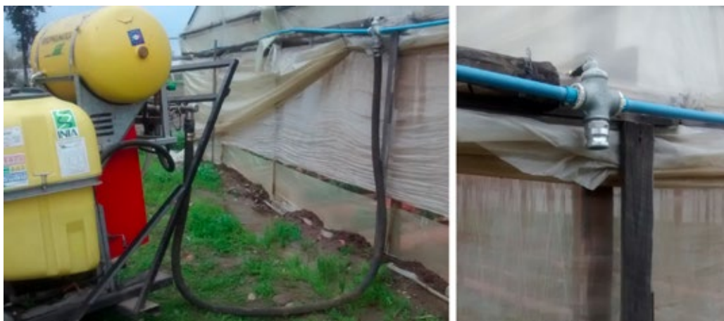
Vista general y detalle de conexión de pulverizador con tuberías principales (proyecto precursor).
